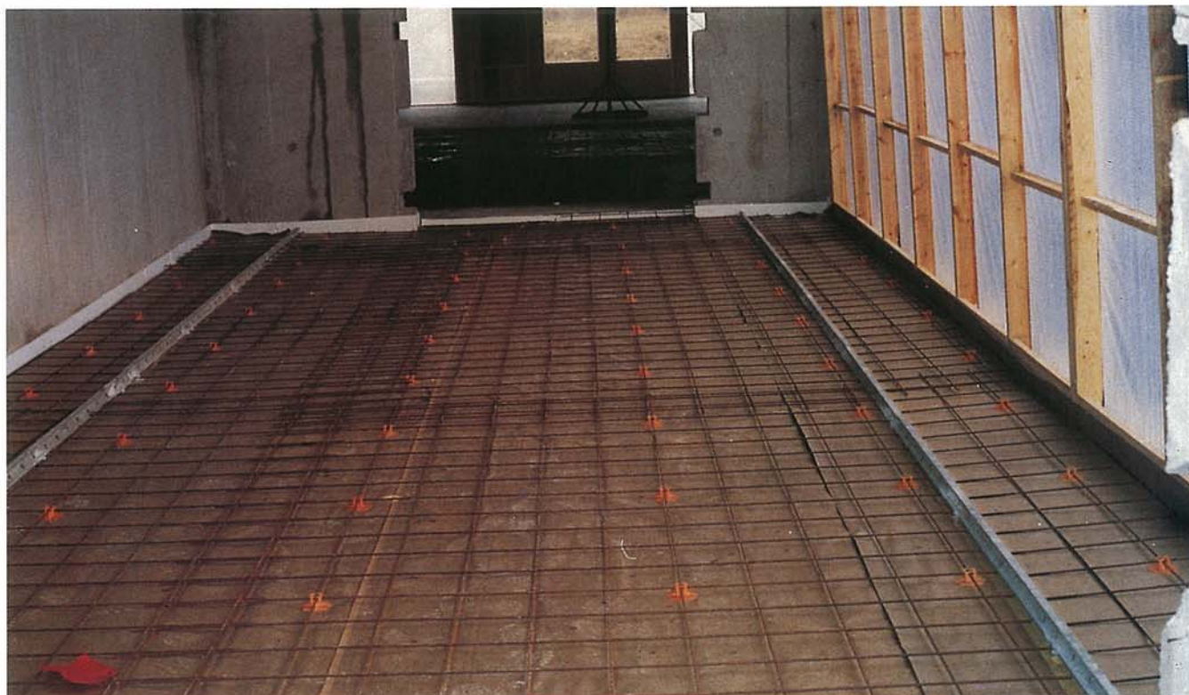
Armeret gulvkonstruktion umiddelbart inden udstøbning. Ledere sikrer, at planhed og tolerancer kan overholdes.
